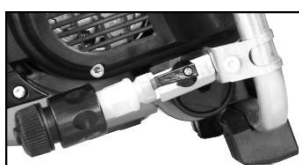
Alimentation d'eau ouverte (levier de vanne parallèle)
